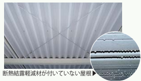
断熱結露軽減材が付いていない屋根▶
